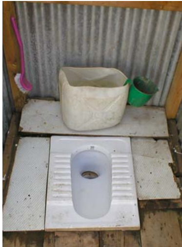
Spültoilette mit geringem Wasserverbrauch in gutem Zustand. Mit dem Kübel wird nach jeder Benützung etwas Wasser nachgeleert, Klopapier wird getrennt gesammelt.
