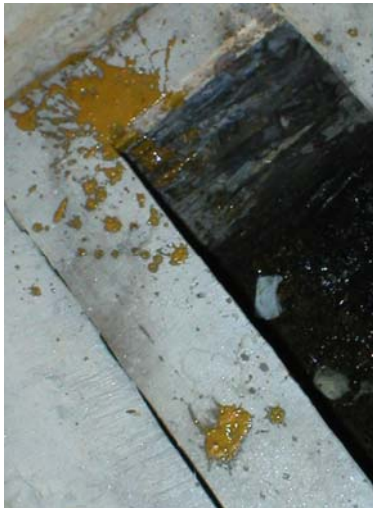
Blick von der Kabine in die Grube. Trotz der großen Öffnung ging etwas daneben. Reinigung erfolgte keine.
