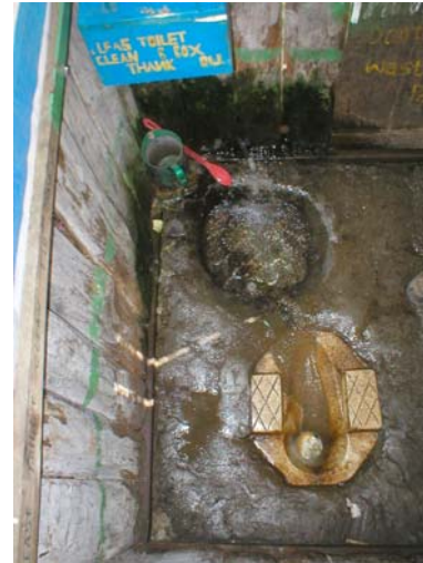
Äußerst bedenkliches „Wasserklosett“ am Bach. Mittels eines Rohres fließt Wasser vom Bach durch die Toilette und wird anschließend wieder direkt zurückgeleitet.
